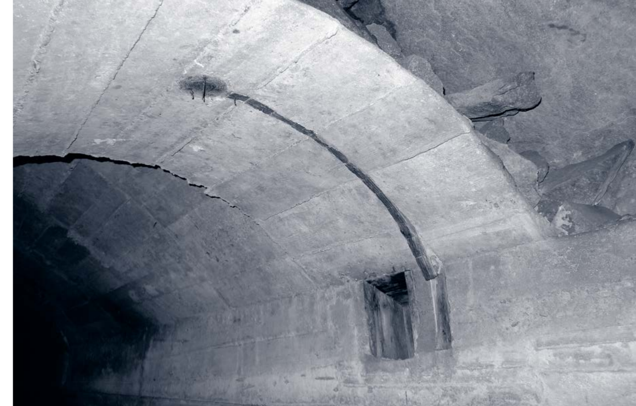
Nicht abgenommene Schalung für eine Deckenleuchte mit Zuleitung
