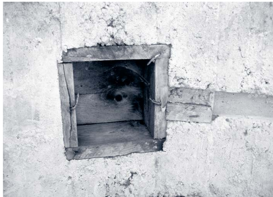
Nie abgenommenes Schalungsholz Cassaforma in legno mai rimossa
