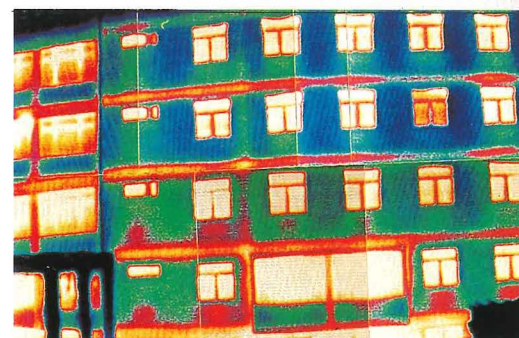
Thermographische Aufnahme eines Gebäudes mit herkömmlicher Wärmedämmung. Deutlich sichtbar: Wärmeverlust im Bereich der Mauerkranze
